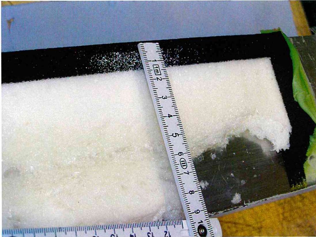
Bild 7: Teilbereich einer geöffneten Systemfuge. Zur Visualisierung der teilweise durchfeuchteten, äußeren Zone war das Fugendichtungsband mit weißem Puderzucker bestreut worden.
