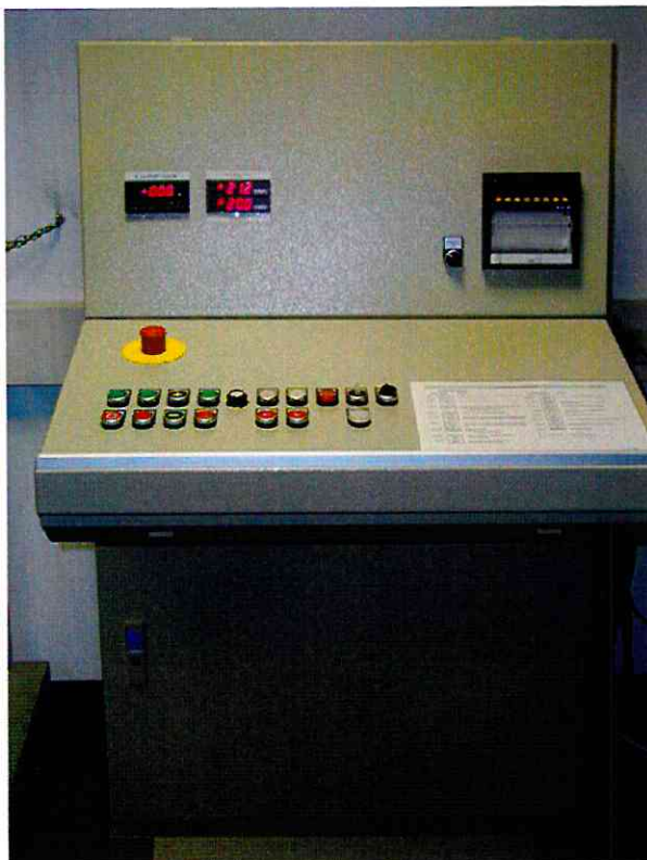
Bild 3a: Prüfstand-Steuerung (Drucksteuerung)
